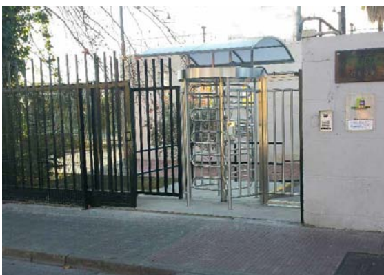
Instalación de nueva puerta y molinete en nuevos accesos controlados al Club Social por C/ Cristóbal Colón, solo con tarjeta de usuario.
